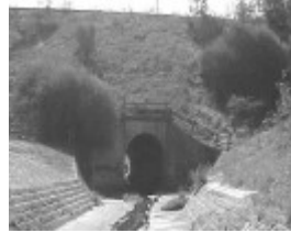
Site 019 - Steele Crk Rail embankment.jpg
