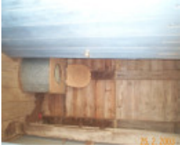
H01120 inglewood court house toilet3 histenviro project feb2003
