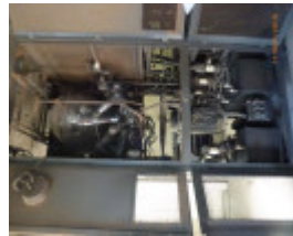
Mercury arc rectifier
