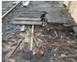
remnant interlocking equip signal box.jpg
